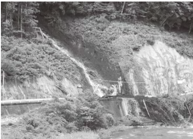
川手（三段峡分かれ）法面崩壊
