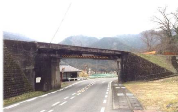
国道改良の妨げとなっている跨道橋
