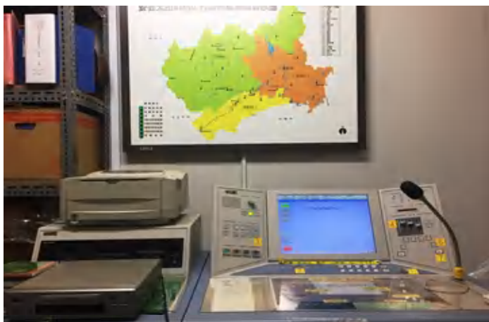
デジタル化が急がれる防災行政無線(同報系)親局設備 (役場本庁)
