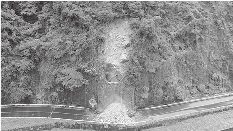
国道433号線 香草付近 崩落現場
